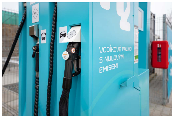
Obr. 33 První veřejná samoobslužná vodíková stanice ORLEN Benzina
